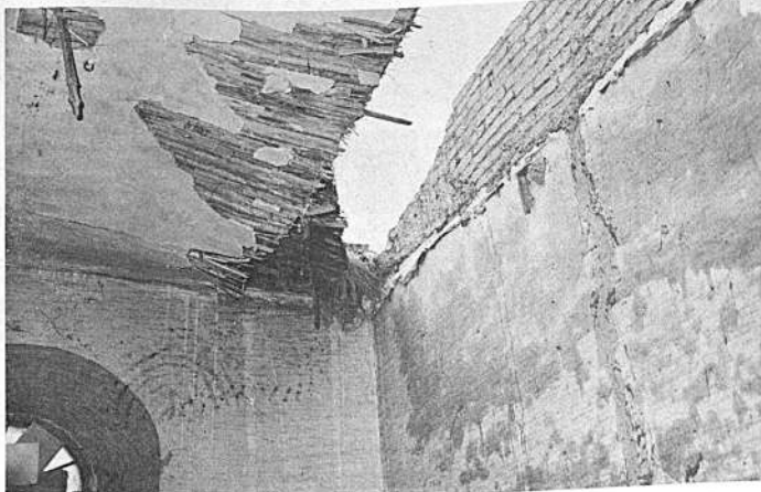
Así quedó el techo de la casa de la Asociación de Periodistas, después del desplome de una parte del tejado. Las intensas lluvias determinaron el remojado de las paredes y rajaduras en la estructura del techado. La Asociación pedirá créditos para reedificar el inmueble a corto plazo.
