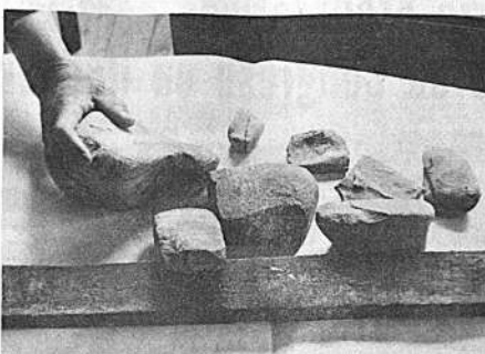
Estas son algunas piedras y obstáculos en la tubería de la zona de Villa Dolores de El Alto y que fueron incrustados intencionalmente por la acción de elementos irresponsables.
