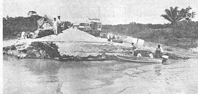
A consecuencia de las inundaciones en el norte cruceño, uno de los caminos que conducen a Yacapaní resultó cortado en una extensión de más de 20 metros por efecto de un fuerte terremoto. En la foto puede observarse el corte producido en el camino donde habrá necesidad de extender un puente. Más información en la página 5. (Foto NIKKA)
