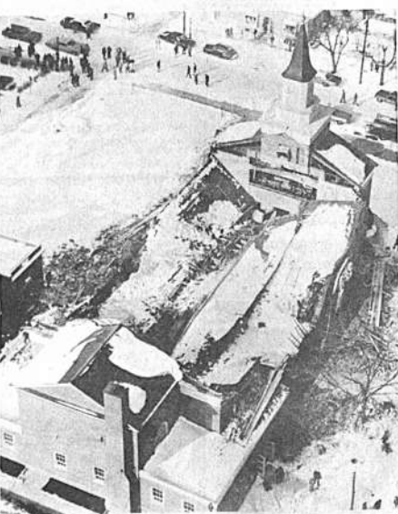
El techo de la Iglesia católica de Santa Rosa de Lima se destruyó la semana pasada, durante una misa atropando a unos cien niños y veinte adultos. El accidente costó heridas a más de veinte personas. El techo cayó después de una nevada de veintiocho centímetros. El hecho sucedió en Baltimore. (AP Wirephoto).
