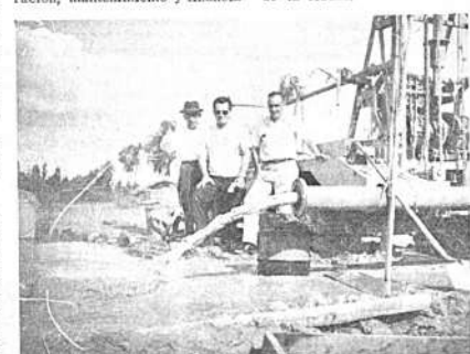
Uno de los pozos de agua potable y está ubicado a pocos kilómetros de la ciudad de Cochabamba. Es parte del programa de la nueva captación de aguas potables para Cochabamba.
