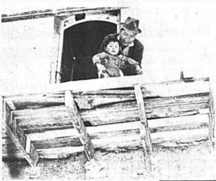
"El Palomar", como todas las dependencias de la cárcel, se encuentra en ruinas: entretechos derrumbados, corredores sin baldosa y con unas cuantas maderas podridas por piso, escaleras sin peldaños. En ese ambiente, viven los presos, muchos de ellos con sus hijos de muy corta edad. Estos niños no conocen otro cielo ni otro sol que los que se divisan desde el fondo de los patios; la libertad para ellos significa vivir encerrados en el interior de los gruesos muros de la cárcel.
