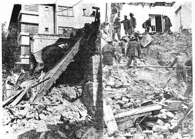
Los restos del estado en que quedó el inmueble de la avenida Ecuador que se derrumbó ayer debido a unas excavaciones que se realizaban en su parte inferior para construir dos almacenes. Las excavaciones debilitaron los cimientos dejándolos sin ningún soporte lo que ocasionó que la construcción se viniera abajo con gran estruendo.
