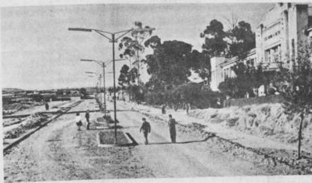
La flamante Avenida del Maestro que hoy será oficialmente inaugurada, está provista de la iluminación nocturna necesaria, gracias a los trabajos realizados por la Cooperativa Eléctrica SUCRE S.A. El gráfico muestra la hilera de postes instalados en el centro mismo de la Avenida para una mejor distribución de la luz.
