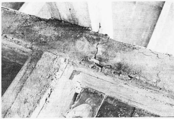
El deterioro de las instalaciones del Terminal del nuevo aeropuerto puede apreciarse en la foto gráfica. Las estructuras se están agrietando.
