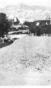
Un trabajo de reparación de cañerías, desde hace más de dos semanas, en la Av. Arce ha ocasionado hasta el momento cuatro accidentes de tránsito arrojando varios heridos, debido a que el promontorio de tierra que se ha formado no posee las necesarias previsiones, especialmente en la noche. Un pequeño grupo de gente se ha formado para señalar a los conductores de motorizados que en la noche existen trabajos de reparación. Los encargados de la obra deben tomar mayores medidas de previsión y corresponde al Tránsito adoptar mayores medios de seguridad. Anteayer uno de los coches presidenciales estuvo a punto de causar otro accidente.
