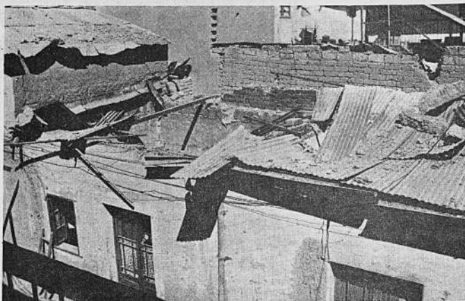
Los destrozos que sufrieron muchas viviendas por los actos de terrorismo de ayer en la mañana, fueron considerables. En el gráfico puede apreciarse el estado en que quedaron algunas casas de la calle Sagárnaga. Los techos se hundieron por el peso de las losas de cemento y adoquines que saltaron de las calles por la violencia de las explosiones.
