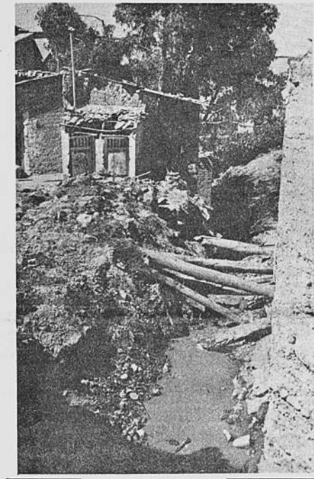
Mas de cien metros del entubado del río Chaqueri quedaron destruidos por las violentas explosiones, cuyo centro fue la calle Sagárnaga.
