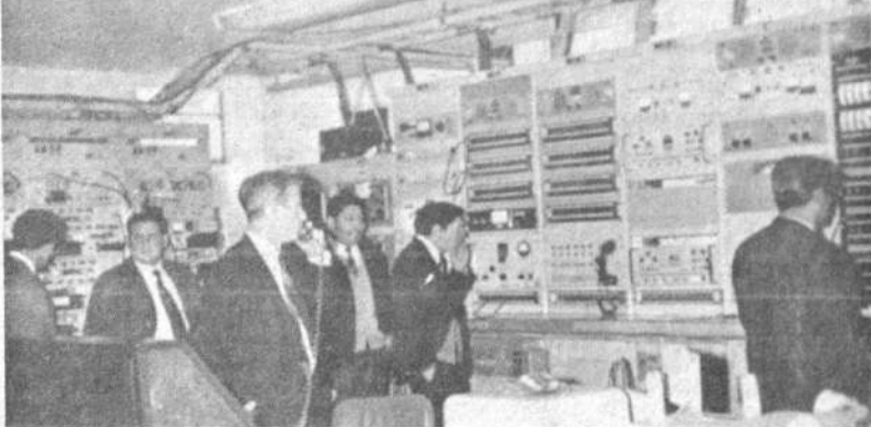
FUNCIONARIOS DE "ENTEL" INSPECCIONANDO LA INSTALACION DE COMUNICACIONES TRANSFERIDA AL GOBIERNO DE BOLIVIA.
