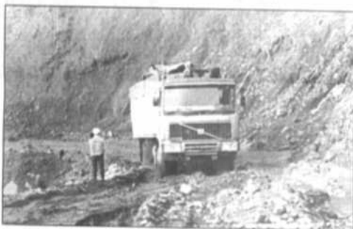
Camino a los Yungas: continuas caídas de pluviosidad dificultan el tránsito normal de los camiones de carga. (FOTO: Prefectura La Paz).
