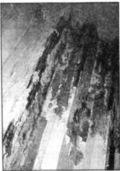
Las filtraciones que se producen en el estadio darían así la parte interna de las graderías.
