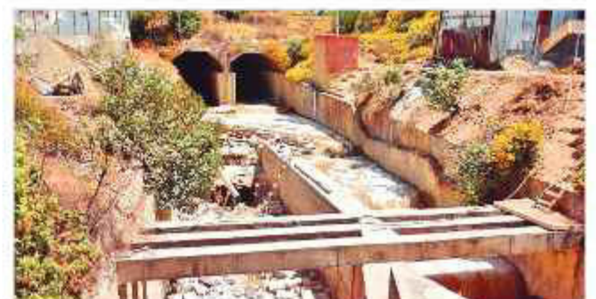
CHOQUEYAPU. El caudal se incrementó por las lluvias.
