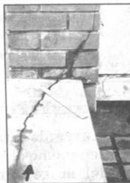
Una de las fisuras detectadas en los muros del edificio del Hospital Japonés
