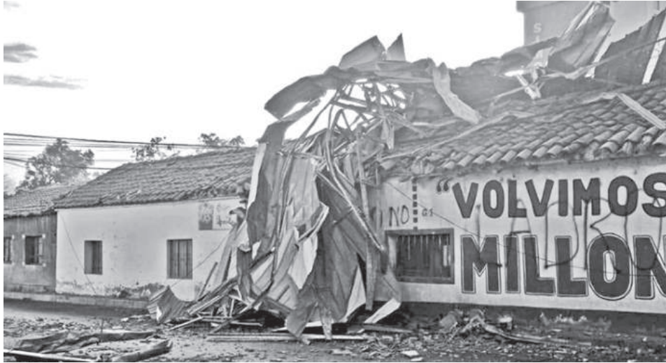
La fuerza del viento levanta el techo de una casa en Tarija, ayer. CIUDAD DEL SUR
