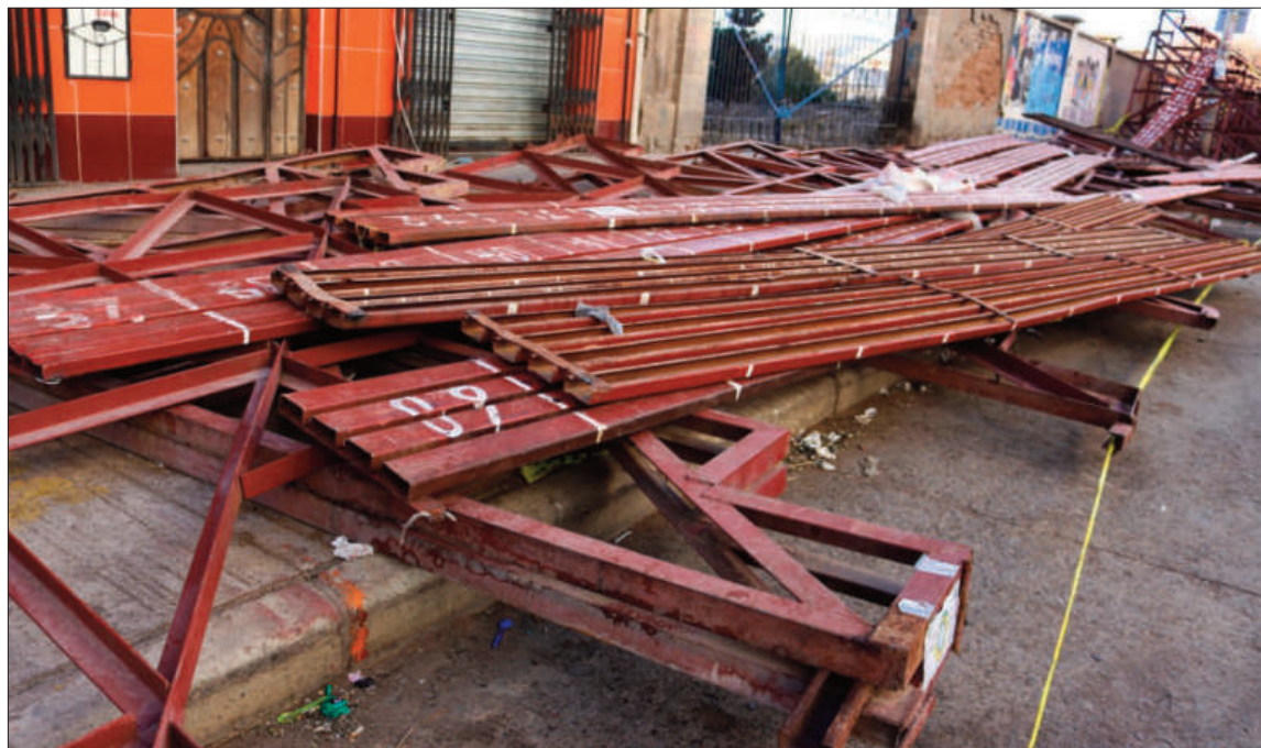
INDICIOS. Toda la estructura de las graderías se vino abajo cuando estaba llena de personas.
