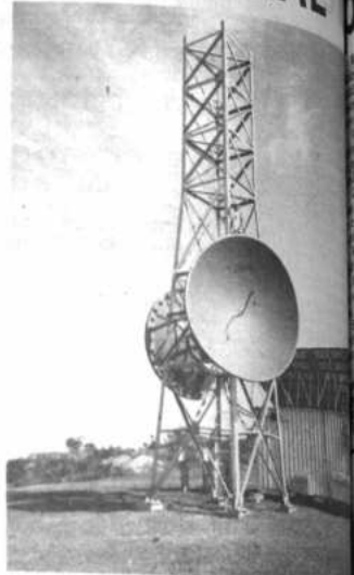
Red de Microondas SANTA CRUZ-FUENTES VERDES en su fase final de ejecución.
