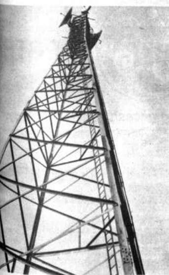
Red de Telefonía Rural para los Departamentos de TARIJA, COCHABAMBA y LA PAZ, en fase final de ejecución.
