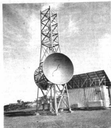
Red de Microondas SANTA CRUZ-PUERTO SUAREZ en su fase final de ejecución.
