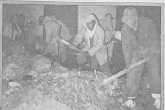
Anegamientos en el barrio del Periodista Varias viviendas del barrio del Periodista, en la zona de Obispos de la ciudad de La Paz, fueron anegadas por el agua que se desbordó hasta la calle Andrés Borge y se inundaron. Según denunciaron los vecinos de la zona, el problema se debe a una falta de previsión de las autoridades municipales, pues "el pequeño chaparrón" que se produjo aproximadamente a las 10.00 horas de la noche fue suficiente para producir problemas e inundaciones, similares a las registradas hace unos 20 años. Una brigada del Hotel de Embarcación de la Alcaldía trabajaba en la zona, luego de haber sido notificada a las 20.00 horas. Esperaban una mala noche para levantar los escombros que se acumularon en la mancomunidad calle, arrastrados de las zonas Bella Vista y Litoral, situadas en la parte superior del barrio del Periodista.
