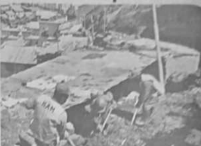
Trabajadores del retén de emergencia rescataron escorcionados en el suelo a una familia que murió a causa de un derrumbe.
