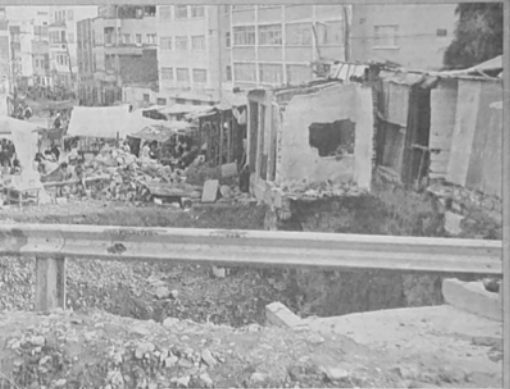
"Sifonamiento" Persiguen lentamente los trabajos de reparación de la calle Rodríguez de la Paz. Afectados desde hace más de dos semanas por un "sifonamiento" producido por una corriente subterránea de agua. La obstrucción de ésta ha dificultado el normal funcionamiento del comercio Rodríguez, el principal de la ciudad.
