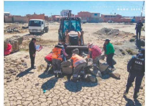
Material de construcción fue retirado del área de dominio municipal /GAMO
