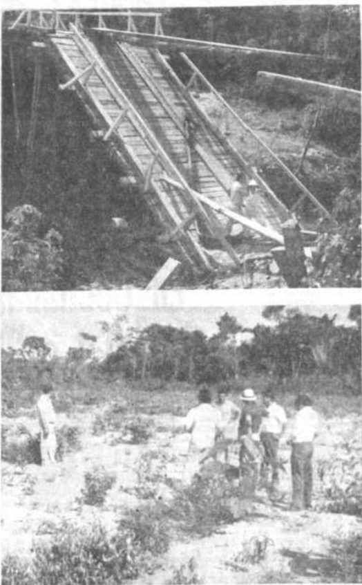
Obras mal construidas en Pando
