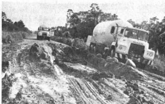
CAMINO DETERIORADO. Esta es una parte del camino que une a Cochabamba con Puerto Villarroel, que en gran parte está deteriorado. Su mantenimiento está a cargo del Servicio de Caminos, que no dispone de los recursos necesarios para cumplir adecuadamente su labor.
