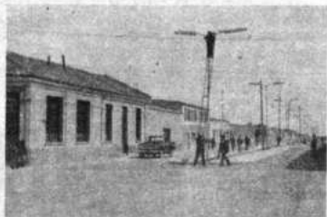
Nueva iluminación eléctrica en una de las principales avenidas.
