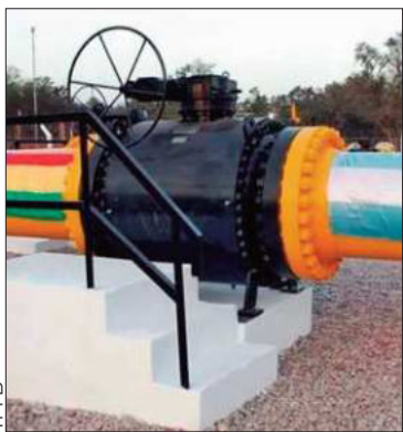
Un gasoducto entre los países.
